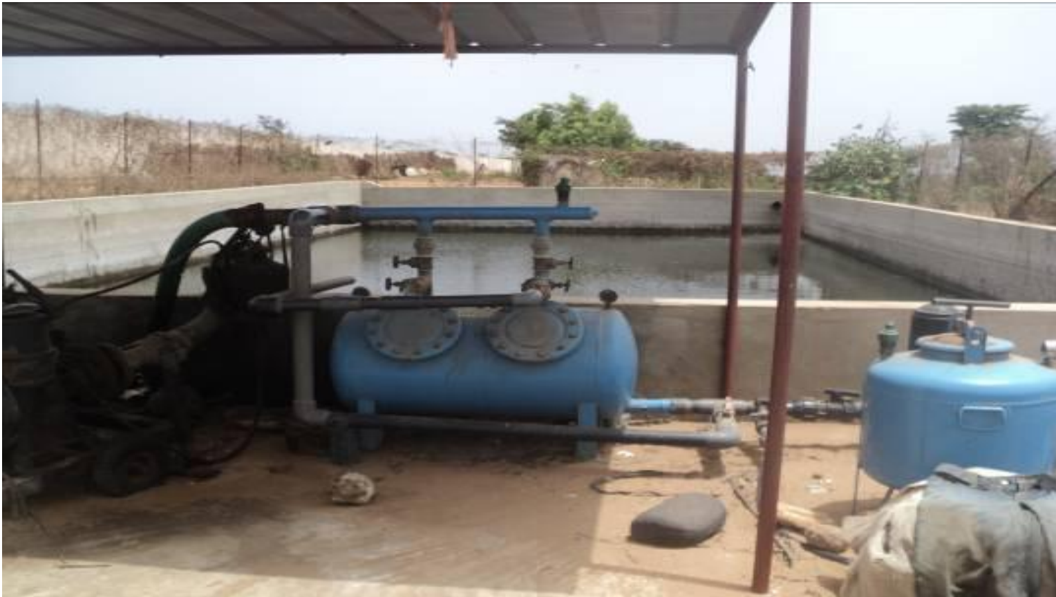
Installation de pompage des eaux usées traitées
